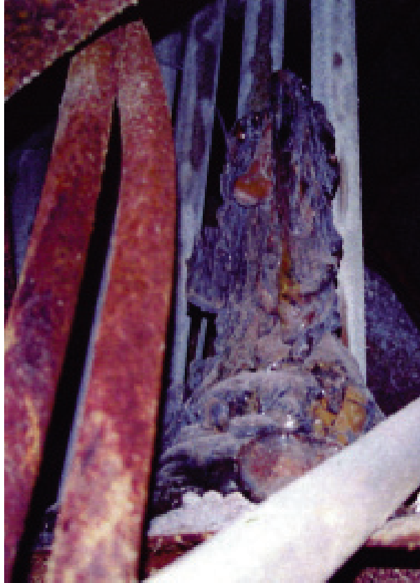
Bränslet finns kvar inne i reaktorn i form av två meterstora droppar. Om de oxiderar och förvandlas till damm kan det radioaktiva dammet läcka ut genom den otäta sarkofagen.
